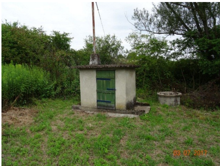
Pumpna stanica Jasenovčani
